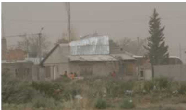
El techo que fue levantado por las fuertes ráfagas.
