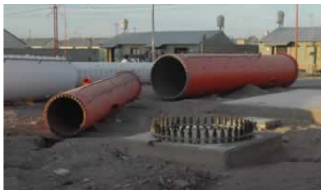
Los caños de la polémica antena de telefonía.
