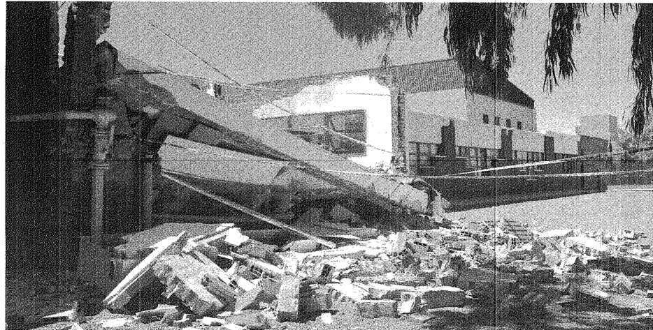
RIESGO TOTAL. EL EPISODIO HIZO DESVELAR A MÁS DE UN FUNCIONARIO, QUE IMAGINÓ EL MISMO DERRUMBE PERO CON ALUMNOS EN PLENA ACTIVIDAD ESCOLAR.
