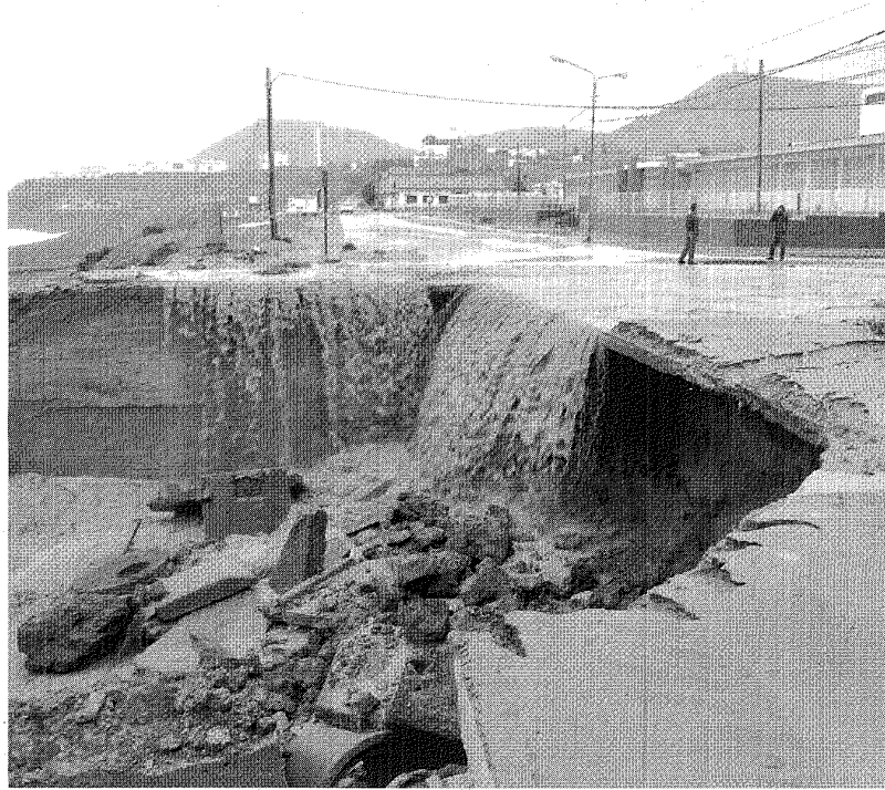
OBRAS PERDIDAS. El pavimento inaugurado un año antes en el barrio General Mosconi fue literalmente "tragado" por un alcantarillado junto a parte del paseo costero con el que se pretendía reforzar el frente del Hospital Alvear.
