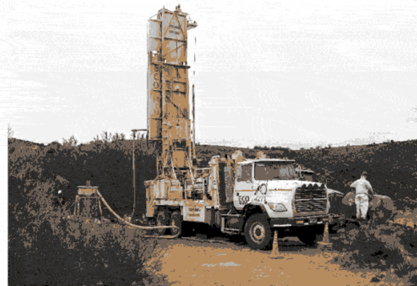
En la etapa del proyecto se está realizando el análisis técnico, entre ellos desde la extracción del mineral hasta la obtención del bullion doré.
