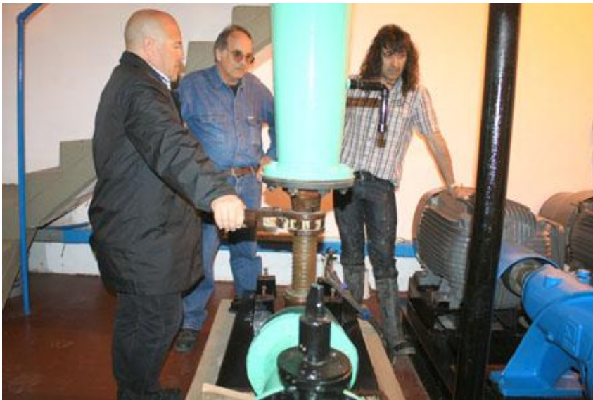
1 - Coustet junto a Roberts en la sala de máquinas, donde están ubicadas las bombas que distribuyen el agua hacia la red domiciliaria.
